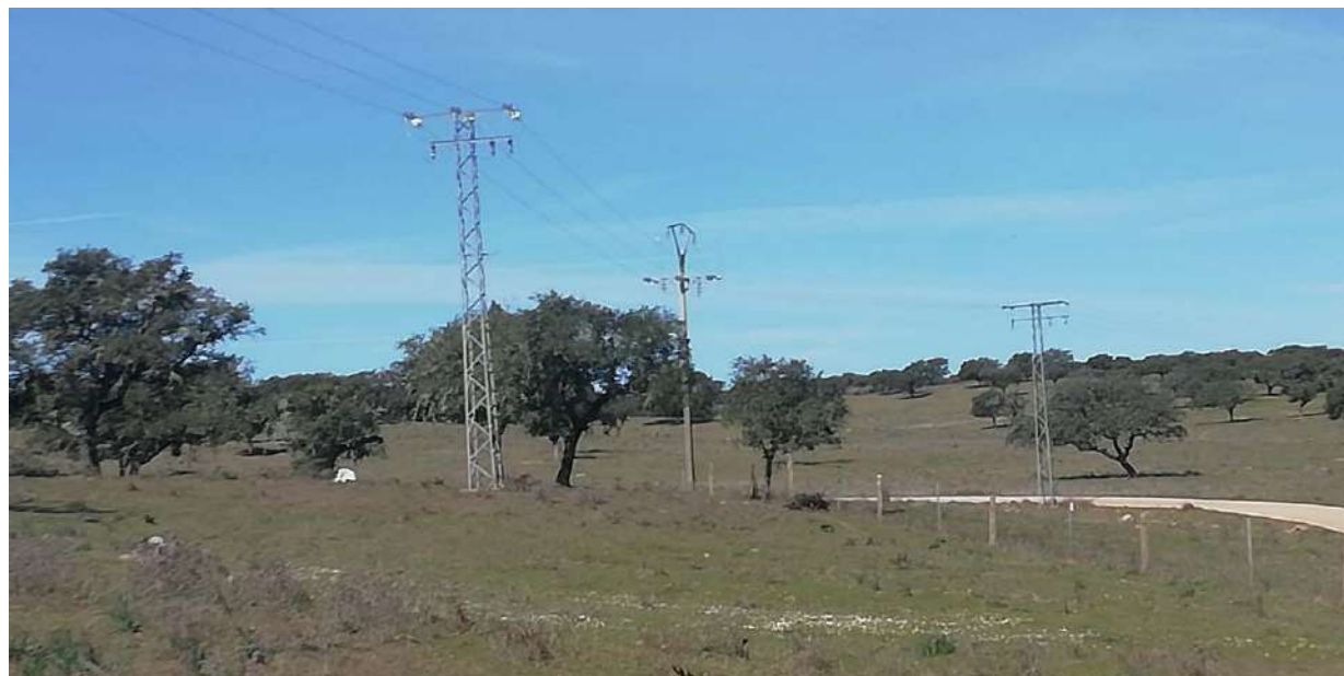
Apoyo 2136 (hormigón) a sustituir y desmontar
