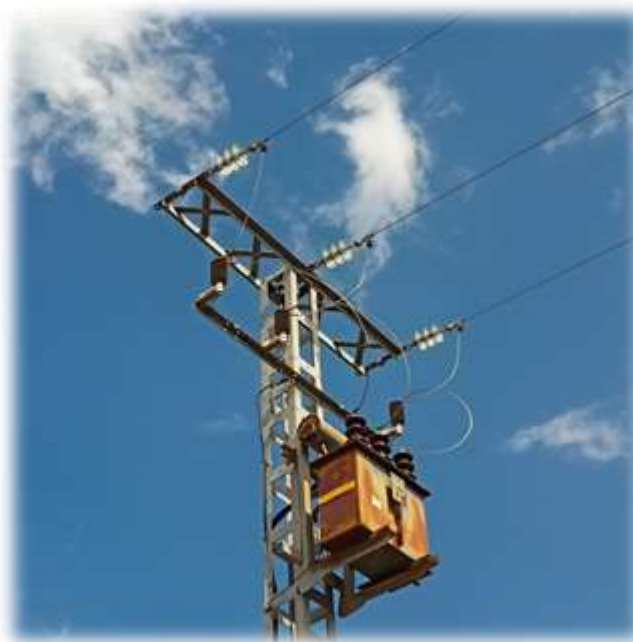
Trafo CTIA "Repetidor TVE" a desmontar
