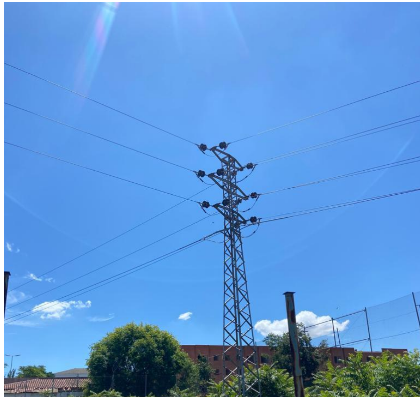
L- "Dehesa" a desmontar, Apoyo 5001 a mantener
