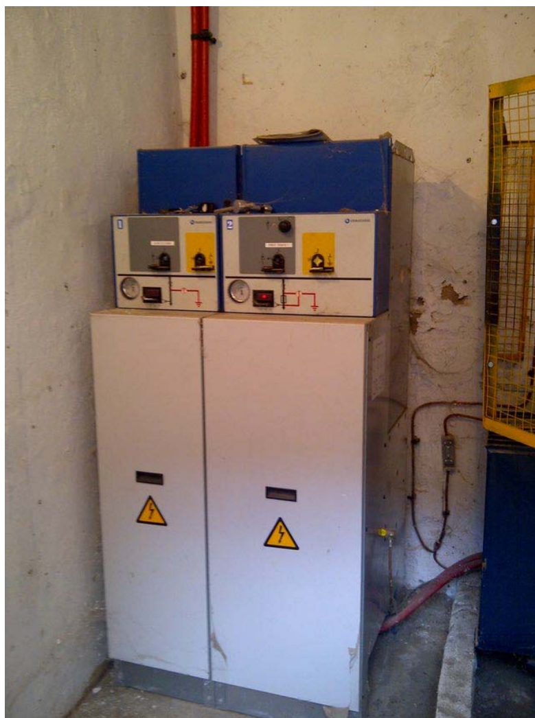
Celdas existentes en el CT "Casillas Coria"
