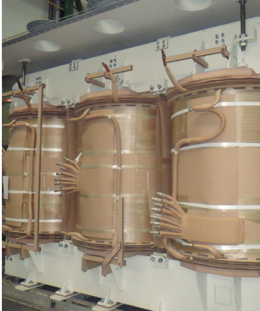
Parte activa del transformador
