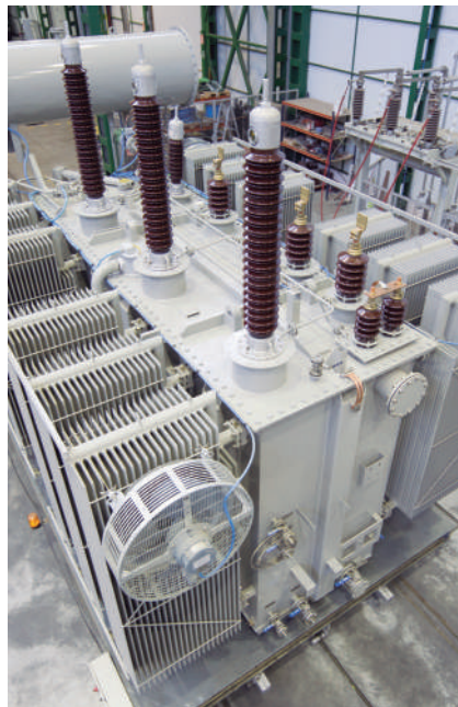
Plataforma para ensayos de potencia
