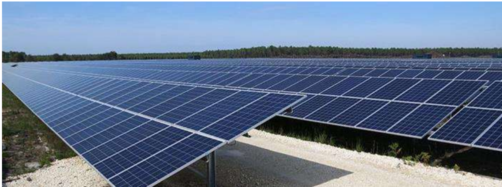
Ilustración 19. Estructura Fija Este-Oeste. Configuración 2V
